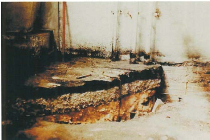
土間コンクリート床の破損
