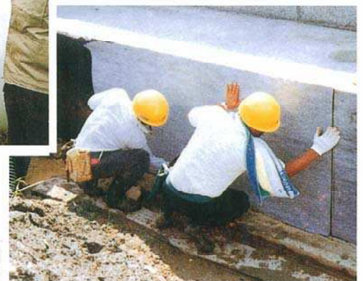
さいたま市人宮地区 ソニックシティビル地下外壁SLシート貼付
