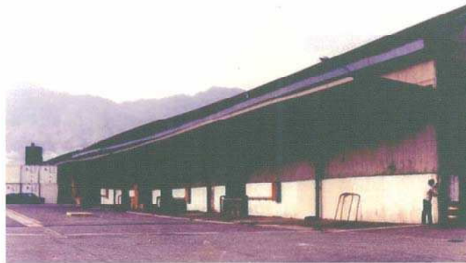
不同沈下建物例
