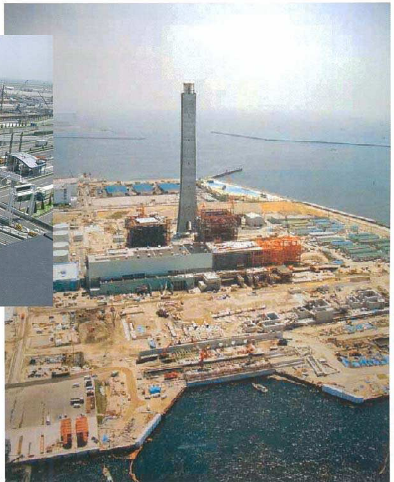
関西電力・大阪南港発電所
