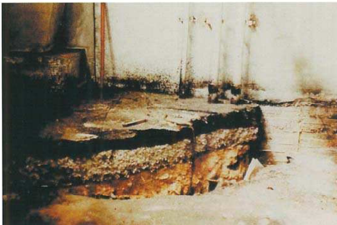
土間コンクリート床の破損
