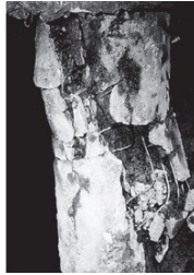
杭頭を剛接した杭の被害例
