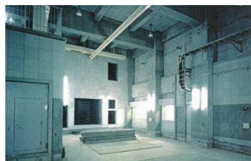
ポンプ場 製品名：ポアセル 50P 工 法：接着工法 (RC:壁面、天井面)
