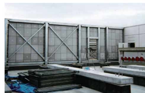
病院屋外機置場 製品名：ポアセル 70W 工 法：接着工法 (押出成形板:壁面)
