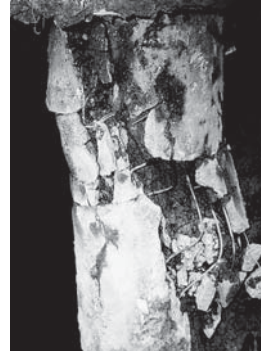
杭頭を剛接した杭の被害例
