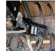
■電流計 (クランプ) オーガ負荷電流を計測します。
