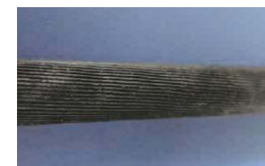
被覆後PC鋼線
