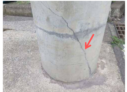
ポールに対して斜め方向のひび割れ
