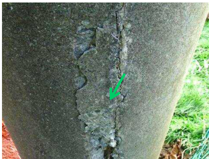
部分的に生じたコンクリート表面の浮き、剥離
