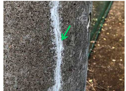
ひび割れ部等に白い粉体が析出した状態
