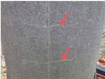
ポールに対して直交方向のひび割れ
