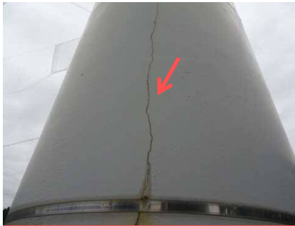
ポールに対して軸方向のひび割れ
